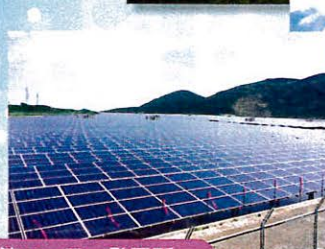
富津ソーラー発電所
